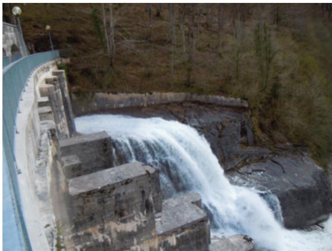
Aliviadero iniciándose el vertido. Véase que el agua discurre directamente sobre la roca de la ladera.
